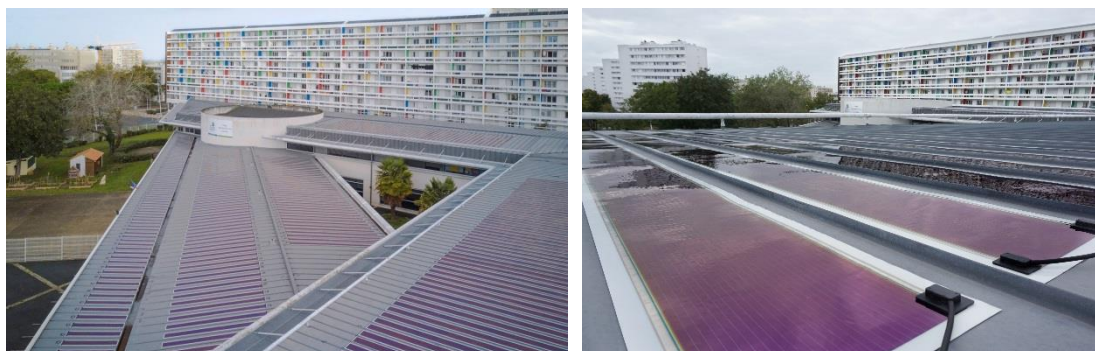
BIOPV Dachinstallation in La Rochelle, HeliaSol ® auf einem Stehfalzdachsystem - © Heliatek GmbH
