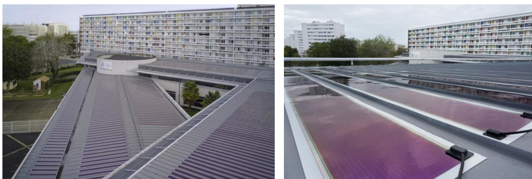
La plus grande installation BiOPV en toiture utilise HeliaSol ® de Heliatek © Heliatek GmbH
